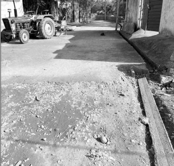
मांडलगढ़ के बिटुलपुर गांव में घटिया निर्माण सामग्री से सीसी सड़क निर्माण कर बेतरतीब नाली बनाई जा रही है।
