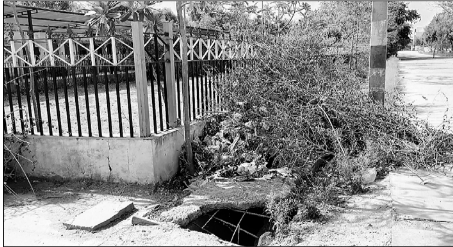
मालपुरा कोर्ट परिसर में कचरा डिपो बने पार्क में घटिया निर्माण से नाले क्षतिग्रस्त हो रहे हैं।
