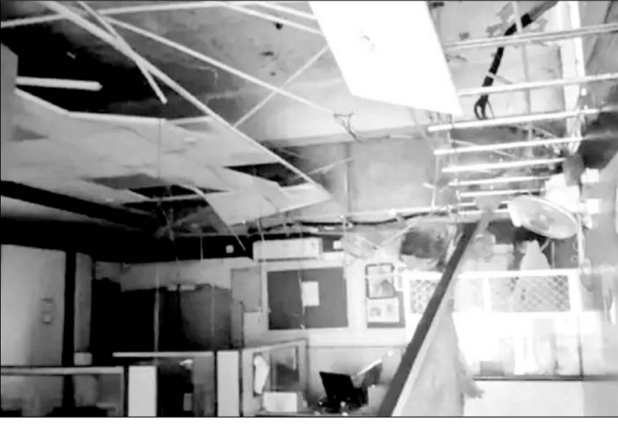
बोरावड़ के यूको बैंक भवन की छत और फॉल सीलिंग अचानक गिर गई।
