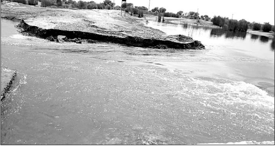
मौरेल नदी पर बनी पुलिया के दोनों किनारों से सड़क टूटकर नदी में बह गई।
