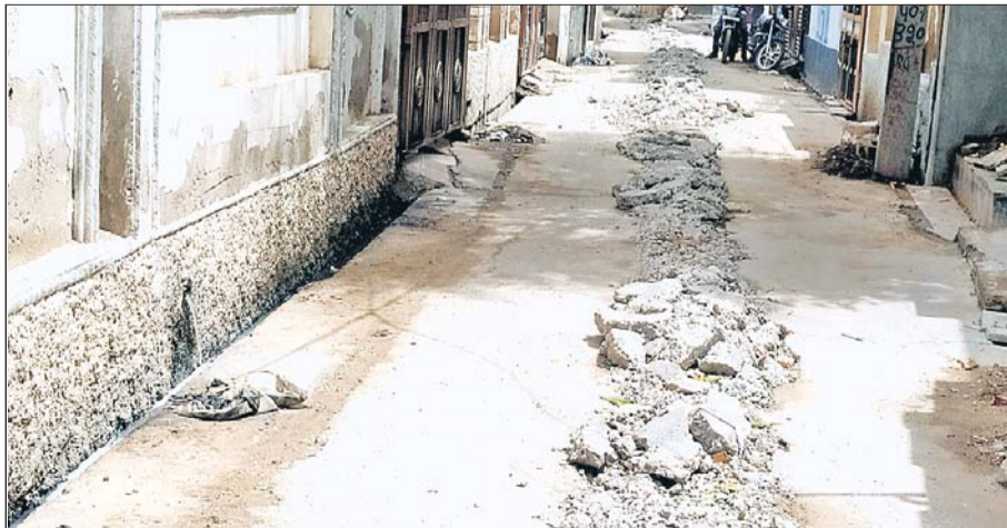
नगरपालिका पावटा प्राणपुरा के वार्ड 11 स्थित शर्मा कॉलोनी में जलदाय विभाग ने इस कॉलोनी में बनी सड़क को पाइप लाइन बिछाने के नाम पर खोद दिया।
