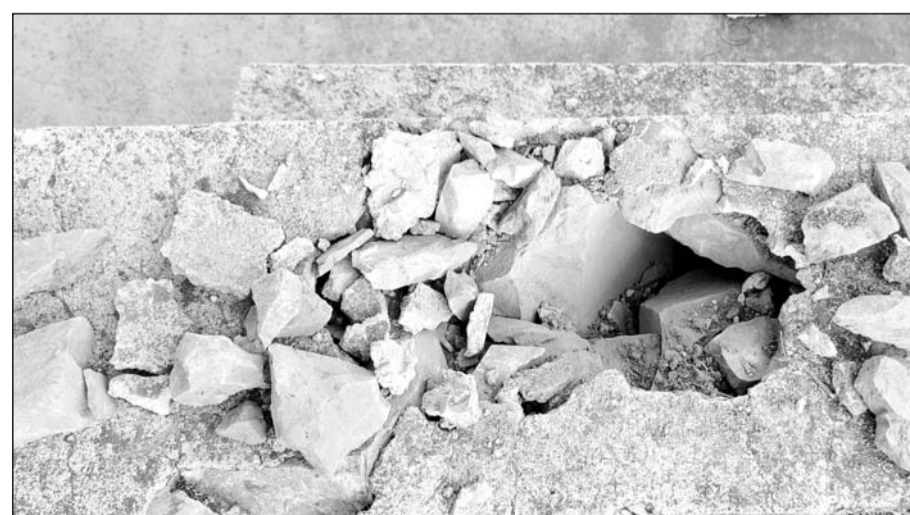
मनोहरपुर में आकाशीय बिजली गिरने से मकान क्षतिग्रस्त हो गया।
