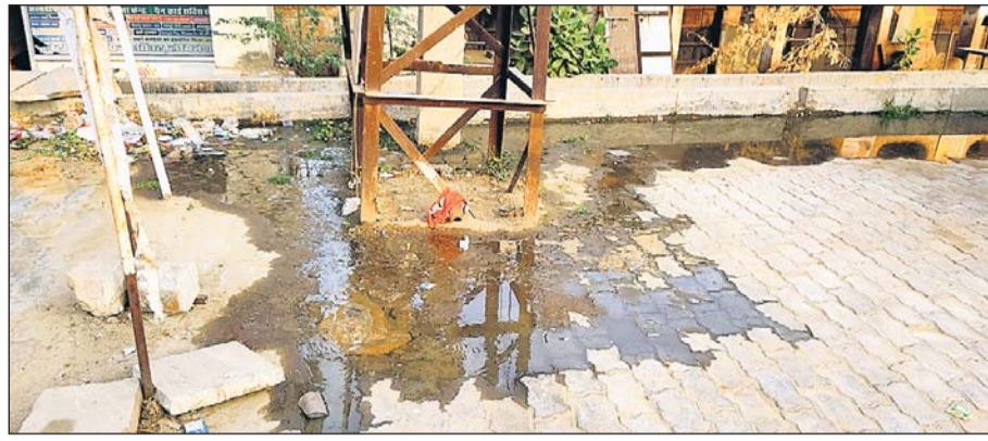
चाकसू में जलदाय विभाग की पाइप लाइन कई जगह लीक हो रही हैं।
