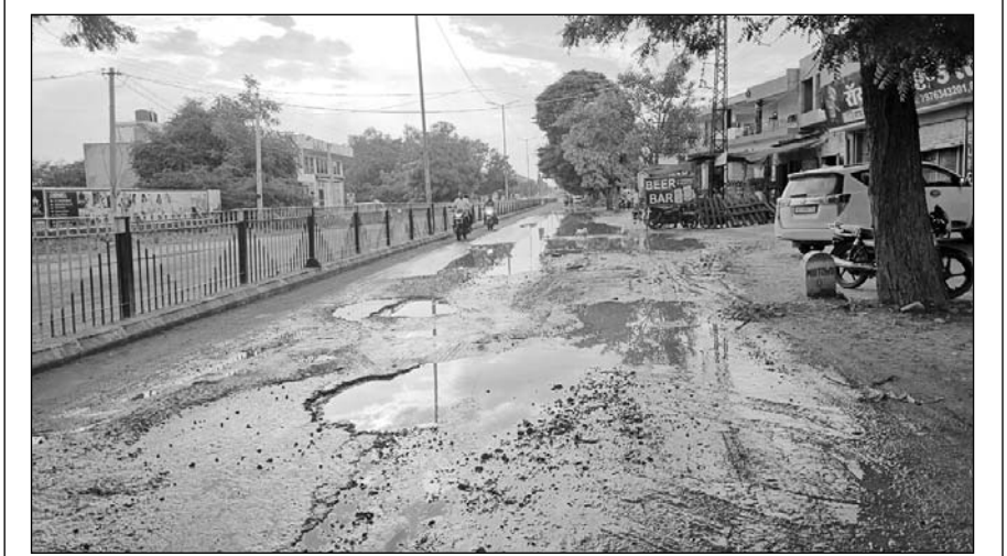
तारानगर : लगभग आठ साल पहले तारानगर शहर में बना गौरवपथ आमजन के लिए आफत बन चुका है। जिसे दो करोड़ रुपये की लागत से सार्वजनिक निर्माण विभाग द्वारा 2017 में बनाया गया था। लगभग एक किलोमीटर लम्बा बना ये गौरवपथ की पूर्ण रूप से क्षतिग्रस्त हो चुका है एवं इसकी दोनों तरफ की सड़कों में दो-दो फ़ीट गहरे गड्ढे हो गए हैं जिसमें आये दिन कोई न कोई हादसा होता रहता है। सैकड़ों वाहन प्रतिदिन इस रास्ते से गुजरते है एवं स्कूल कॉलेज में अध्ययनरत हजारों बच्चों का इस रास्ते से आवागमन है, जिन्हें परेशानी का सामना करना पड़ रहा है।
