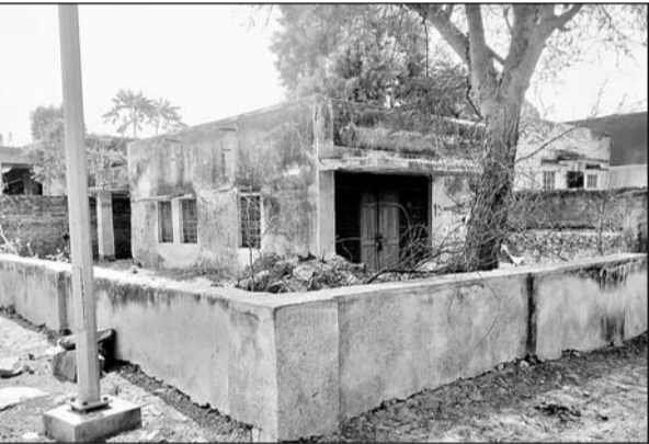
जिला मुख्यालय पर स्थित रीको का एक भवन जर्जर होकर अवैध गतिविधियों का स्थान बन गया है।
