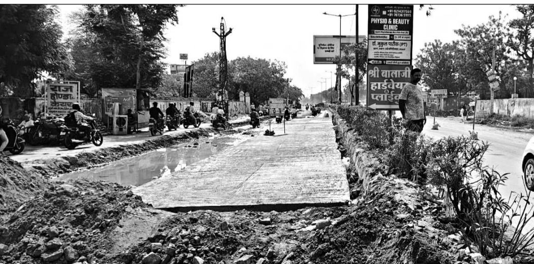
कालवाड़ रोड पर मंगलम सिटी के सामने सीमेंट रोड बनाने के लिए ठेकेदार पेवर मशीन के बजाय मजदूरों से काम करवा रहा।
