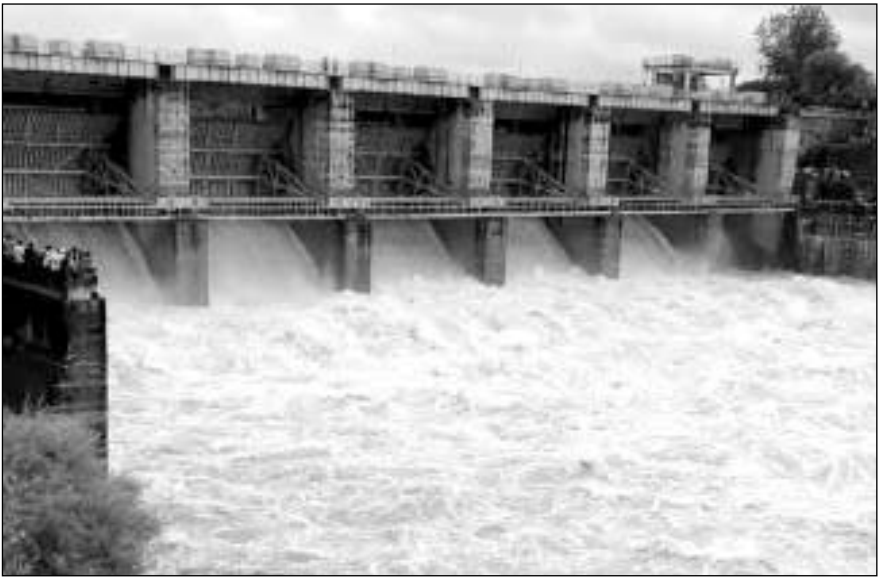
करौली के सबसे बड़े पांचना बांध के चार गेट खोलकर लगातार पानी की निकासी की जा रही है।
