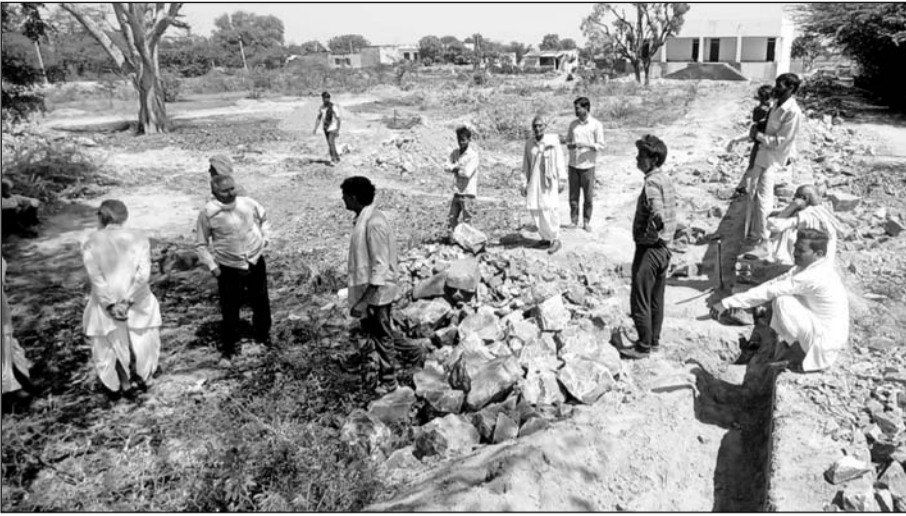
गांव गोपालपुरा में चल रहे विद्यालय की चारदीवारी निर्माण कार्य में घटिया सामग्री लगाने को लेकर ग्रामीणों ने निर्माण कार्य बन्द करवाया।
