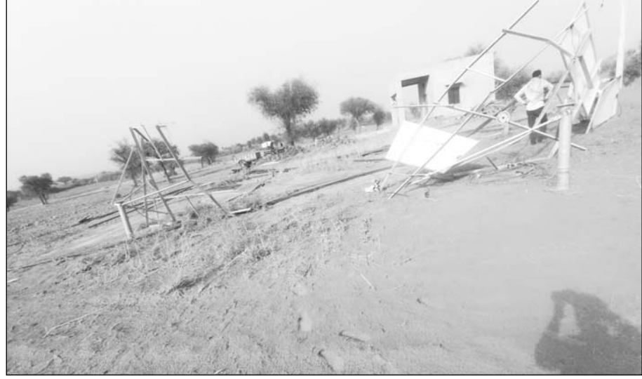
चूरू में आंधी तेज आंधी से ग्रामीण अंचल में लगी सोलर प्लेटें उड़ गईं।
