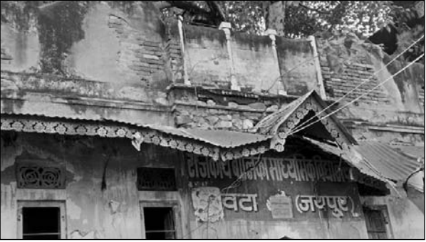
पावटा में पुराना विद्यालय भवन जर्जर अवस्था में पहुंचा।
