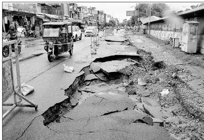
मुरलीपुरा इलाके में दादी का फाटक के पास बुधवार-गुरुवार की मध्यरात्रि तेज बारिश के कारण मुख्य सड़क धंस गई। मिट्टी कटाव के कारण डामर रोड भरभराकर जमीन में बैठ गई। गनीमत रही कि उस वकत कोई भारी वाहन यहां से नहीं गुजर रहा था, अन्यथा बड़ा हादसा हो सकता था।
