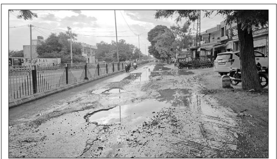
तारानगर : लगभग आठ साल पहले तारानगर शहर में बना गौरवपथ आमजन के लिए आफत बन चुका है। जिसे दो करोड़ रुपये की लागत से सार्वजनिक निर्माण विभाग द्वारा 2017 में बनाया गया था। लगभग एक किलोमीटर लम्बा बना ये गौरवपथ की पूर्ण रूप से क्षतिग्रस्त हो चुका है एवं इसकी दोनों तरफ की सड़कों में दो-दो फ़ीट गहरे गड्ढे हो गए हैं जिसमें आये दिन कोई न कोई हादसा होता रहता है। सैकड़ों वाहन प्रतिदिन इस रास्ते से गुजरते है एवं स्कूल कॉलेज में अध्ययनरत हजारों बच्चों का इस रास्ते से आवागमन है, जिन्हें परेशानी का सामना करना पड़ रहा है।
