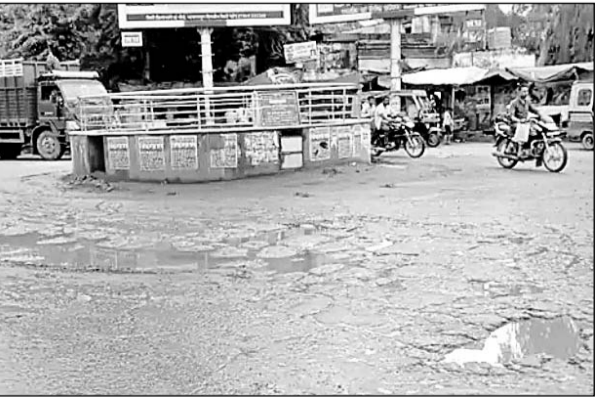
हिण्डौन में सक्रिल के पास बदहाल पड़ी सड़कें।
