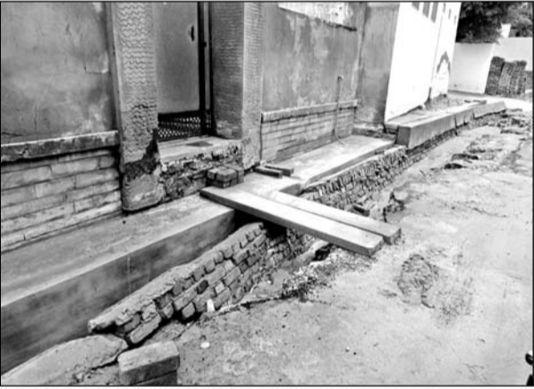
प्रगति नगर में बना रहे नाले की दीवार बारिश में टूटकर बिखर गई।
