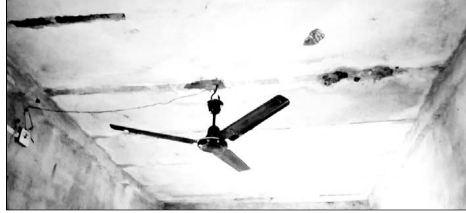
क्षतिग्रस्त सांगठकलां विद्यालय की जर्जर छत व टपकता पानी।
