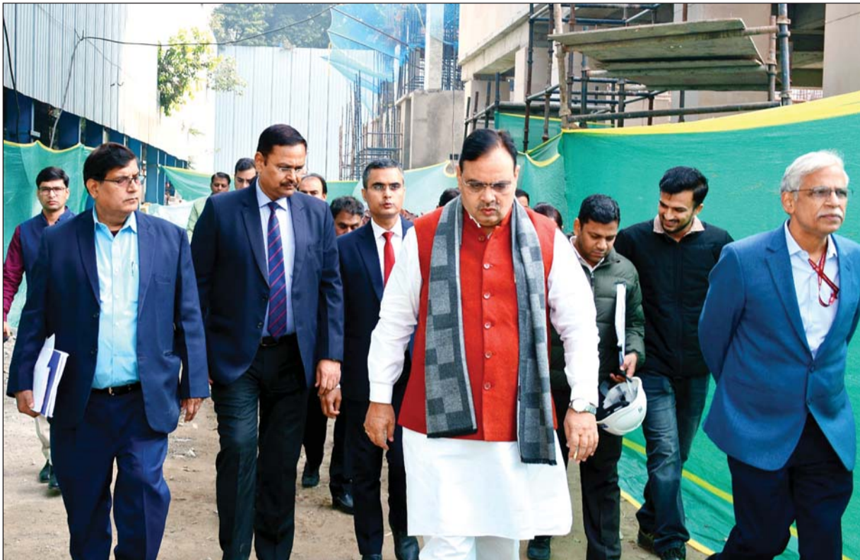
मुख्यमंत्री भजनलाल शर्मा ने गुरुवार को दिल्ली स्थित बीकानेर हाउस, उदयपुर हाउस और राजस्थान हाउस के पुनर्निर्माण कार्यों का निरीक्षण किया। उन्होंने अधिकारियों को निर्देश दिये कि समय-सिमा के साथ निर्माण कार्य में गुणवत्ता का विशेष ध्यान रखा जाए।
