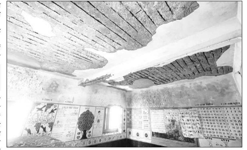
छत में लगे लोहे के सरिमे बाहर नजर आने लगे हैं।
