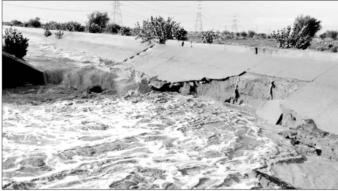
बाप के कालू खां की ढाणी के पास बरसाती नदी में सड़क बह गई।
