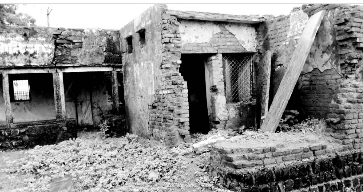
क्षेत्र की घाटाखेडी पंचायत के गोविंदपुरा का प्राथमिक स्कूल का भवन जर्जर अवस्था में होने से अनहोनी का अंदेशा बना हुआ है।
