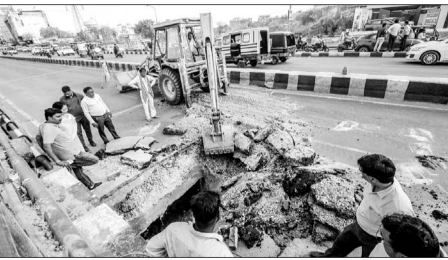
गोपालपुरा बाईपास पर गुर्जर की थड़ी अंडर पास के नजदीक धंसी मुख्य सड़क को जेडीए की टीम ने ठीक करने का काम शुरू किया।
