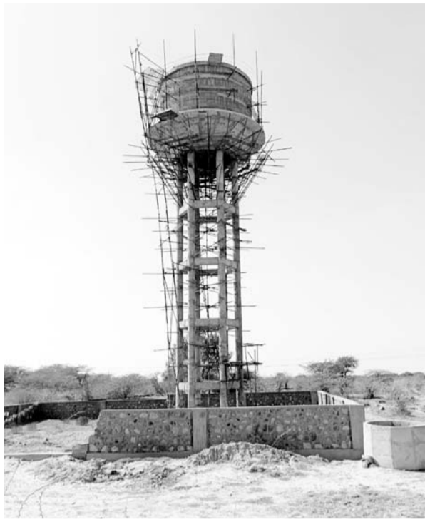
गुढ़ा में टंकी निर्माण कार्य लंबे समय से अटका पड़ा है।
