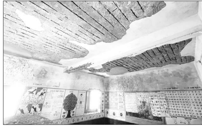
छत में लगे लोहे के सरिये बाहर नजर आने लगे हैं।
