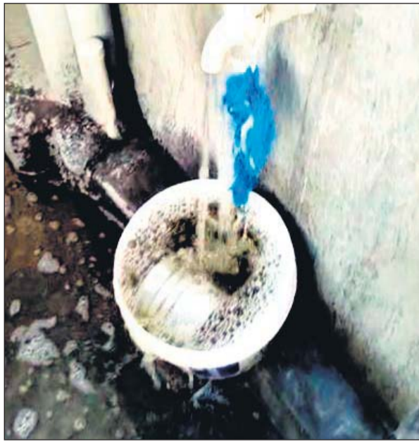
पाइप लाइन क्षतिग्रस्त होने से नलों में गंदा पानी आ रहा है।
