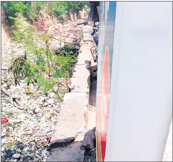
चाकसू के मध्य से निकलने वाले नाले में भरा कचरा।
