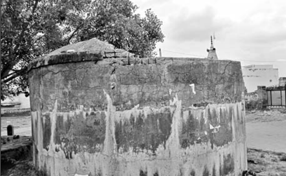
राजलदेसर तहसील के निकटवर्ती गांव आलसर बास में करीब 33 वर्ष पूर्व बनी पानी की टंकी जर्जर हो चुकी है।
