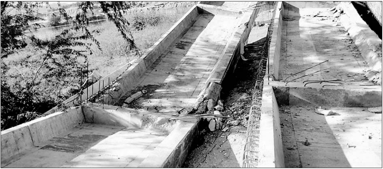
संगमेश्वर पुल का सोमवार को गिरा हिस्सा जो कि घटिया निर्माण की पोल खोल रहा है।
