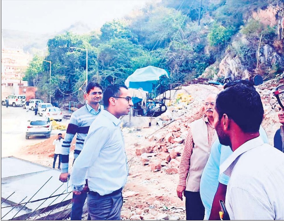
जयपुर कलेक्टर प्रकाश राजपुरोहित ने शुक्रवार को खोले के हनुमान मंदिर परिसर में पहुंचकर रोप-वे निर्माण का निरीक्षण किया।
