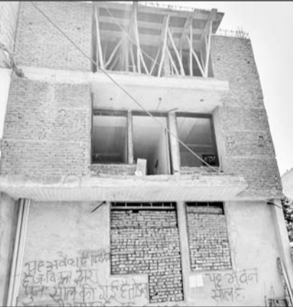
डाल दी। दूसरी मंजिल पर दीवारों और पिल्लरों का निर्माण कर छत डालने के लिए शर्टरिंग की जा रही थी। जेडीए की टीम जब रुटीन चैक के लिए वहां पहुंची तो बिल्डिंग में निर्माण कार्य होता दिखा। टीम ने वहां रखे कंस्ट्रक्शन मैटैरियल को जब्त कर इमारत को पुनः सीज किया।
