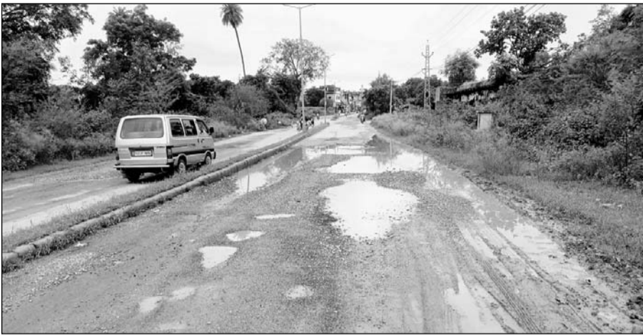
पुलिस थाने के पास बद्दहाल अवस्था में गौरव पथ।
