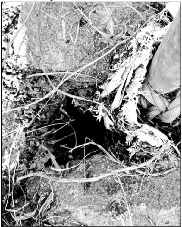
देरवाला में सड़क किनारे खुला पड़ा बोरवैल हादसों को न्यौता दे रहा है।
