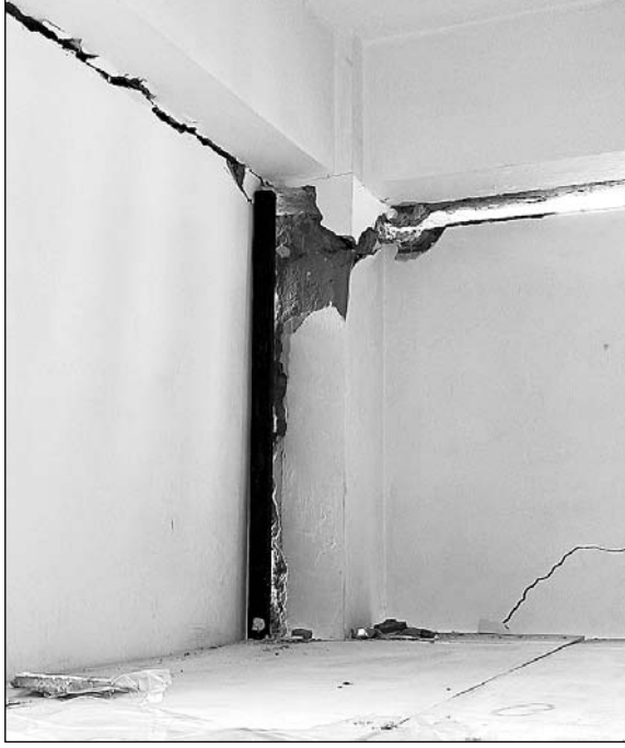
सवाई मानसिंह अस्पताल में निर्माणाधीन कार्डियक सेंटर में पानी के टैंक निर्माण के लिए खुदाई से क्षतिग्रस्त हुई दुकान।
