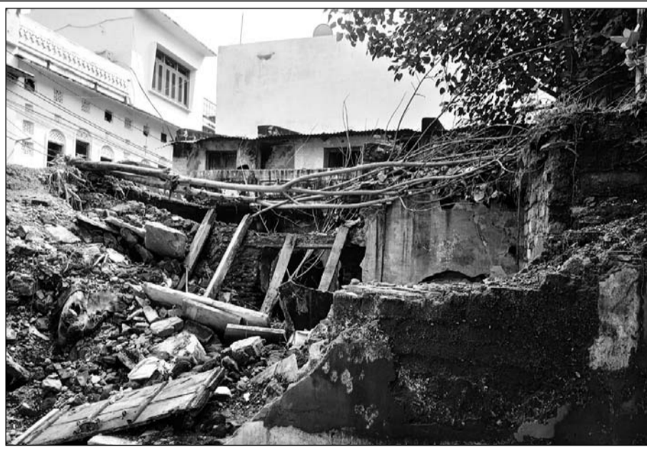
देवली शहर के बीचों-बीच जर्जर अवस्था में खड़े भवन हादसे को न्योता दे रहे हैं।
