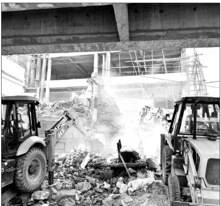
विधानसभा चुनावों से पहले झोटवाड़ा एलिवेटेड रोड का निर्माण कार्य पूरा करने के लिए जयपुर विकास प्राधिकरण के अधिकारी इन दिनों पुरजोर जुटे हुए हैं। मंगलवार को इस पुलिया के निर्माण में बाधा बन रही 8 दुकान, पांच मकान, सीढ़ियां व अन्य स्ट्रक्चर को जेसीबी से ध्वस्त किया।
