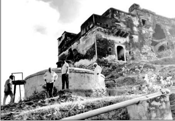
पहाडी पर बनी इस टंकी से पानी की सप्लाई की जाती है लेकिन कीड़े, मकोडे एवं गंदगी होने से ग्रामीण गंदगी पानी पीने को मजबूर है।
