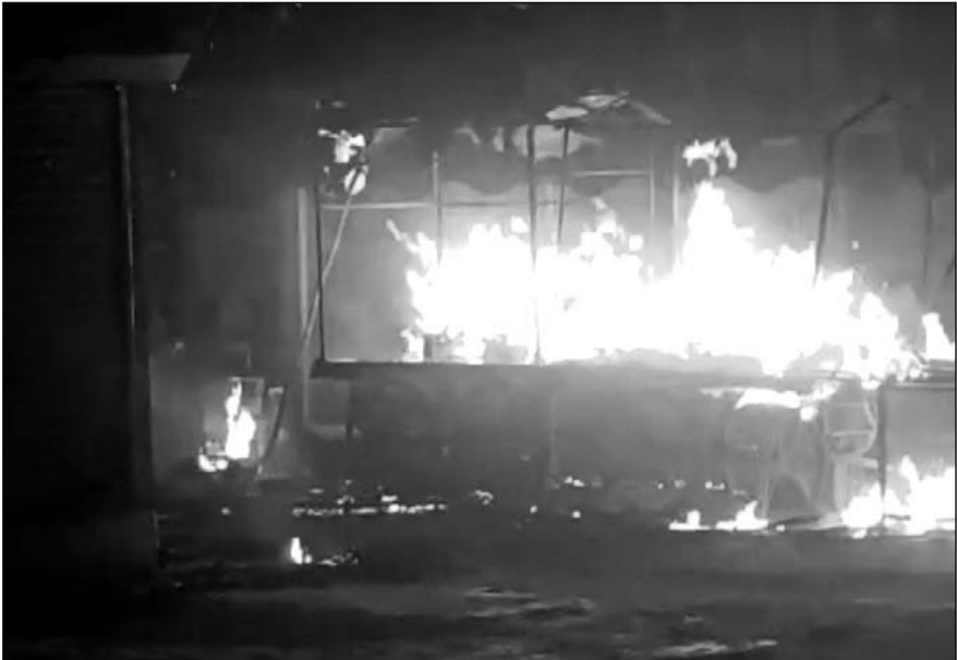
श्रीमाधोपुर कस्बे के मुख्य चौपड़ बाजार में रात्रि में बिजली के ट्रांसफ़ॉर्मर में अचानक आग लग गई।
