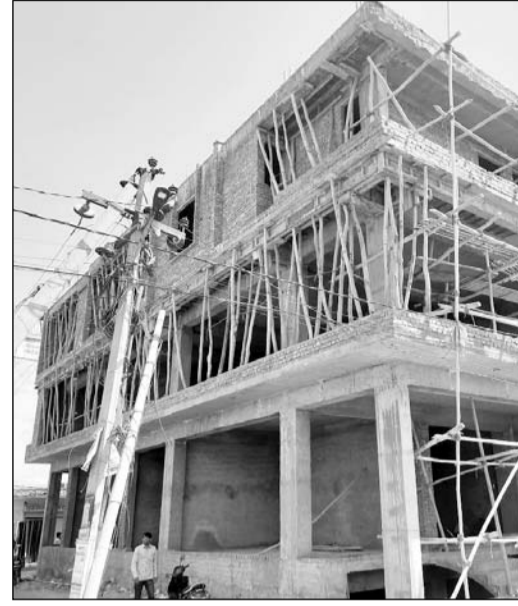
निगम के सांगानेर जोन ऑफिस के पास अवैध निर्माण
