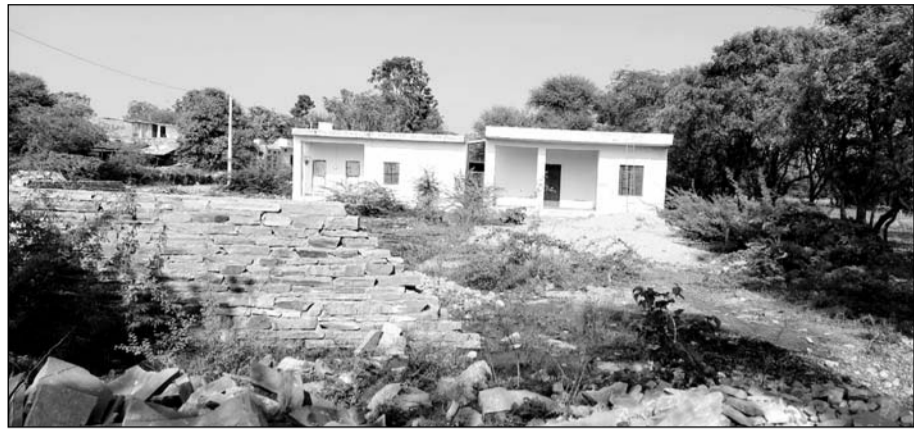
माण्डलगाढ़ के रलायता पंचायत में सामुदायिक भवन की बाउंड्री निर्माण का कार्य एक साल से अधूरा पड़ा है।
