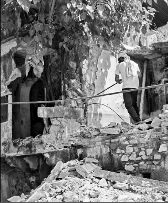
हैरिटेज नगर निगम के किशनपोल जोन की टीम ने इलाके में जर्जर इमारतों को शुक्रवार को ध्वस्त किया।
