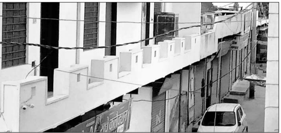
महिला पार्षद का मकान जहां लाइन से डायरेक्ट कनेक्शन ले रखा है।
