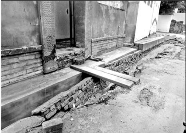
प्रगति नगर में बना रहे नाले की दीवार बारिश में टूटकर बिखर गई।
