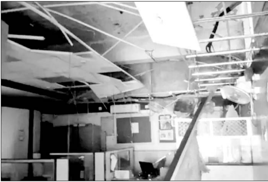
बोरावड़ के यूको बैंक भवन की छत और फॉल सीलिंग अचानक गिर गई।
