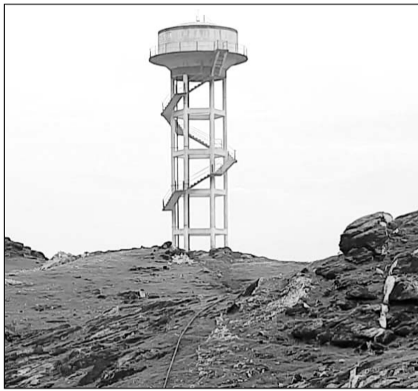
डूंगरखेड़ा ग्राम पंचायत के भरतवा गांव में निर्मित पानी की टंकी और कुआँ लेकिन ग्रामीणों को जल आपूर्ति नहीं हो रही है।
