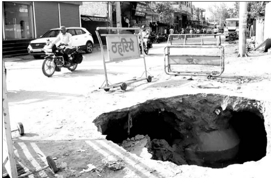
कोटपूतली में सीवरेज निर्माण कम्पनी की लापरवाही से सड़क पर कई जगह पर गड्डे हो गये।
