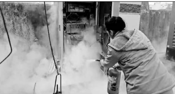
पैनल में लगी आग को बुझाया।
