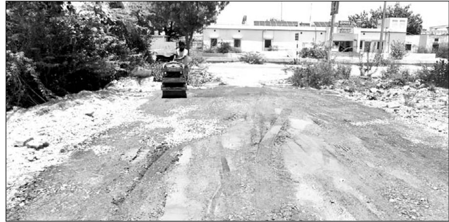
बोरावड़ नगरपालिका क्षेत्र में सड़कों के निर्माण कार्य में घटिया सामग्री के उपयोग और नियमों की खुलेआम अवहेलना का मामला सामने आया।
