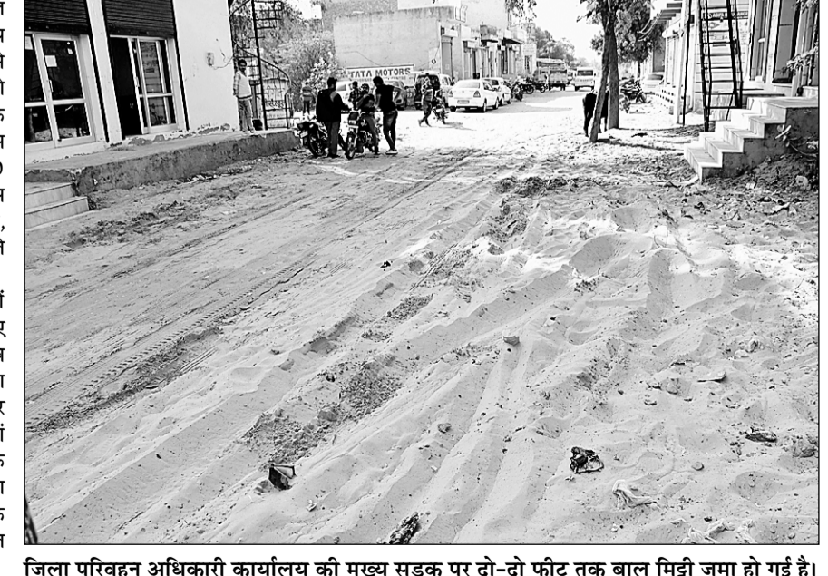
जिला परिवहन अधिकारी कार्यालय की मुख्य सड़क पर दो-दो फीट तक बालू मिट्टी जमा हो गई है।
